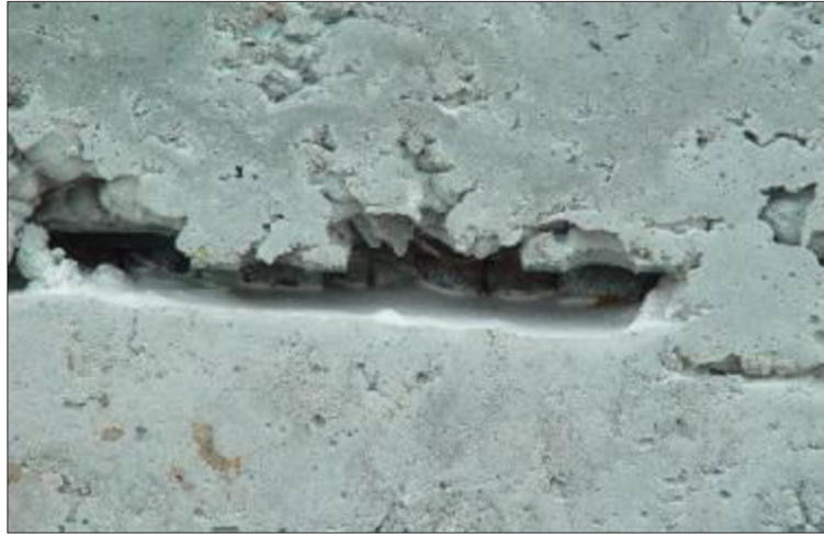
Obr. 11: Kaverna vzniklá nedokonalým zhutněním betonové směsi [O27]
