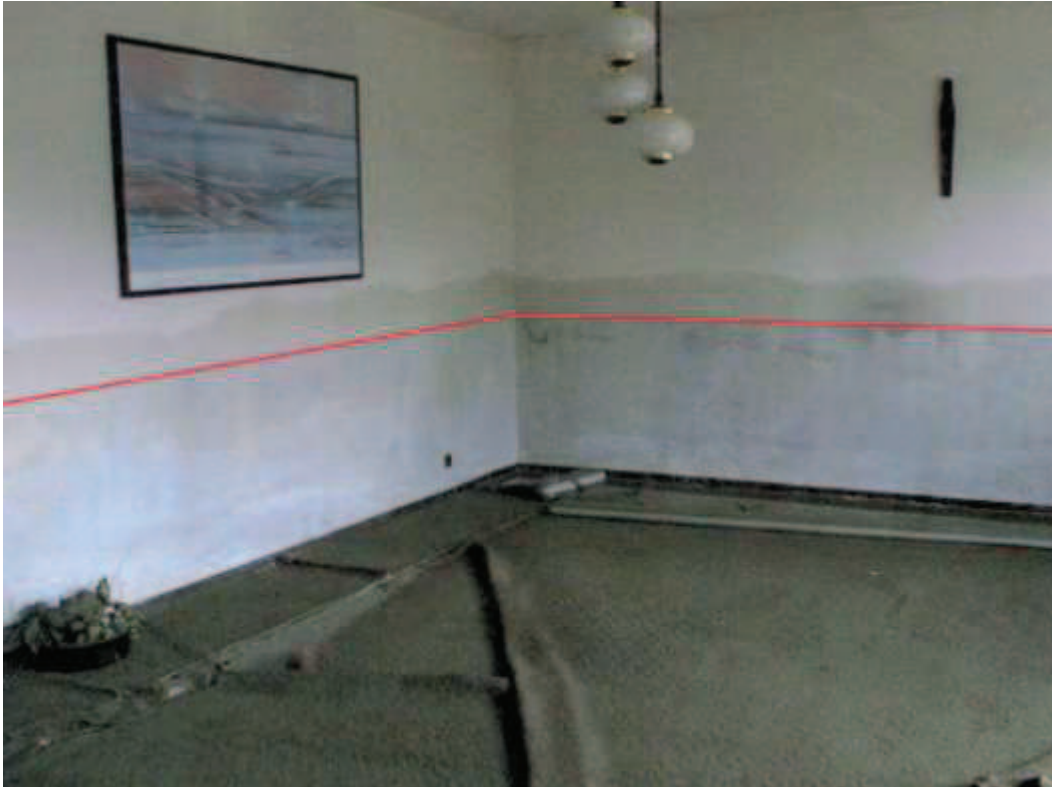
Obrázek č. 5 Obývací pokoj – červená linka zobrazuje výšku hladiny vody
