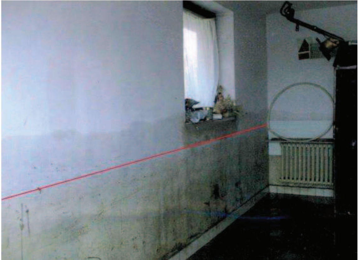
Interiér – 1NP, Garáž, červená linka zobrazuje nejvyšší vodní stav v srpnu 2002.
