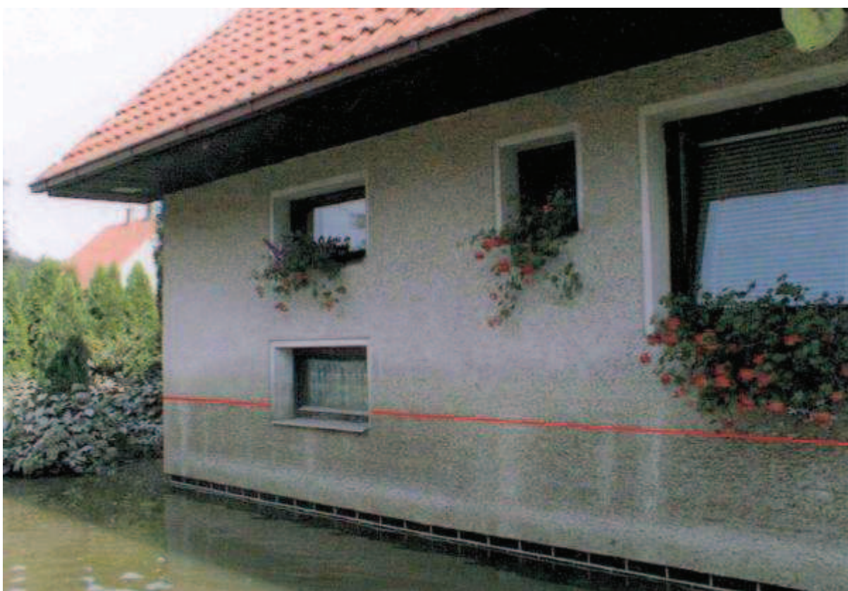
Exteriér objektu, červená linka zobrazuje nejvyšší vodní stav v srpnu 2002.
