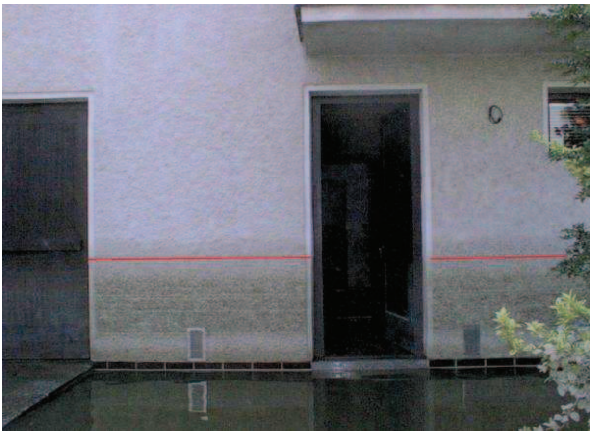
Exteriér objektu, červená linka zobrazuje nejvyšší vodní stav v srpnu 2002.
