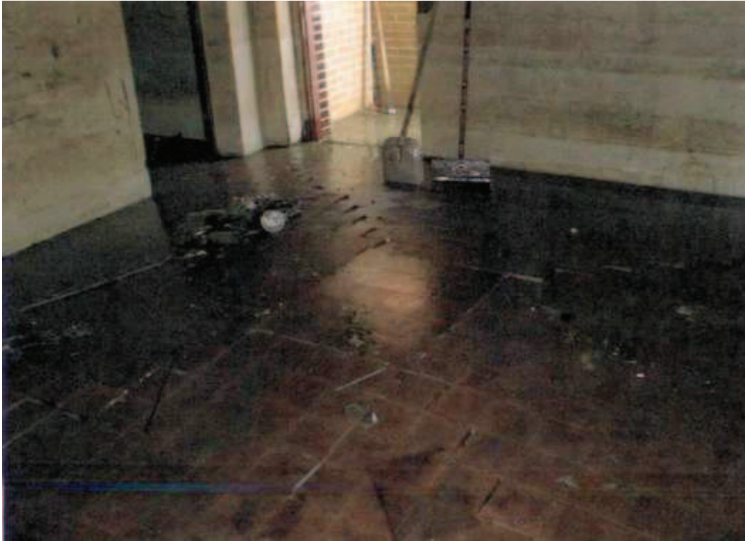
Obrázek č. 3 Vzduťá betonová podlaha: Sklep I
