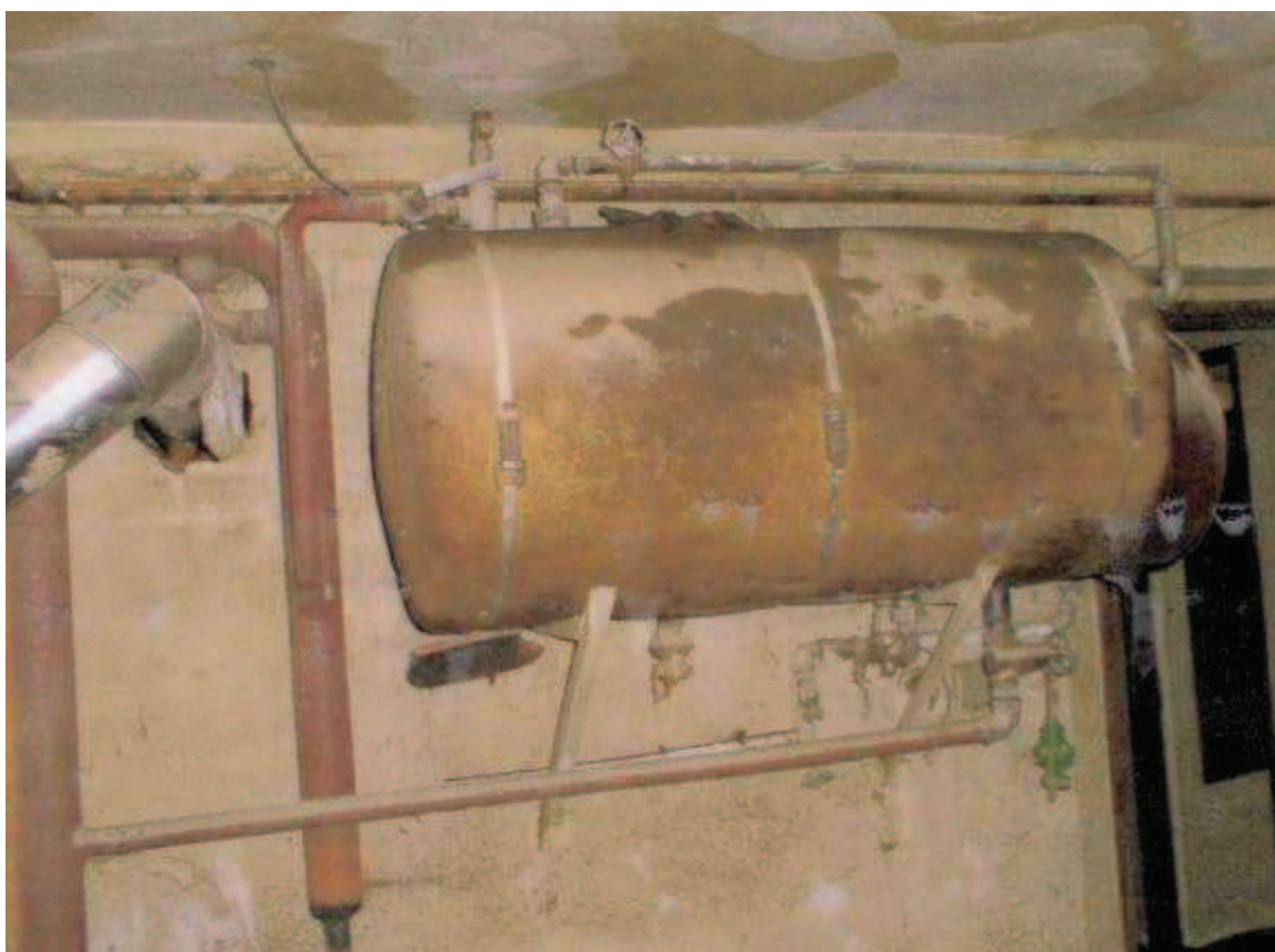
Interiér – 1PP, Kotelna, Elektrický zásobníkový ohřivač vody.
