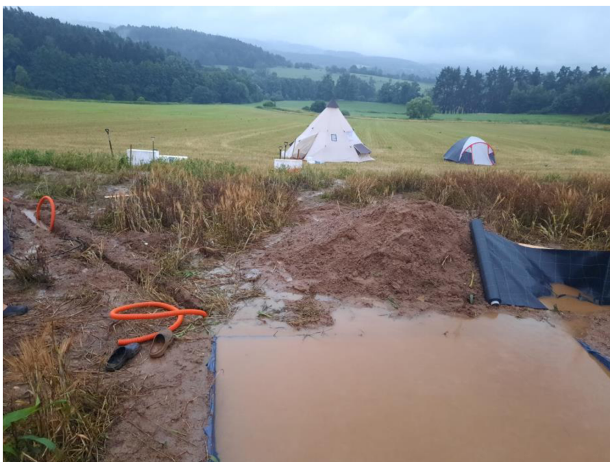
Obr. č. 21 - Poničení instalovaných prvků při dokončovacích pracích (vlastní foto 6/2022).
