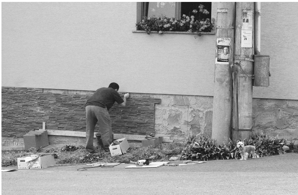
Obr. 31. Väčšina ľudí si myslí, že vidiek na Západe vyzerá lepšie, pretože tam majú viac financií. Ak je prírodný kameň prelepovaný betónovou napodobeninou kameňa dôvody je potrebné hľadať inde. Nesluša (foto: Milan Šuška)
