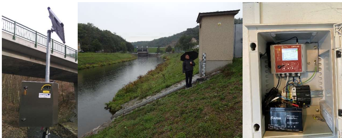
Obr. 10. Napájení elektřinou ze solárního panelu (vlevo), limnigrafická stanice (uprostřed), skříňka se zapisovačem dat a akumulátorem (vpravo) [3]
