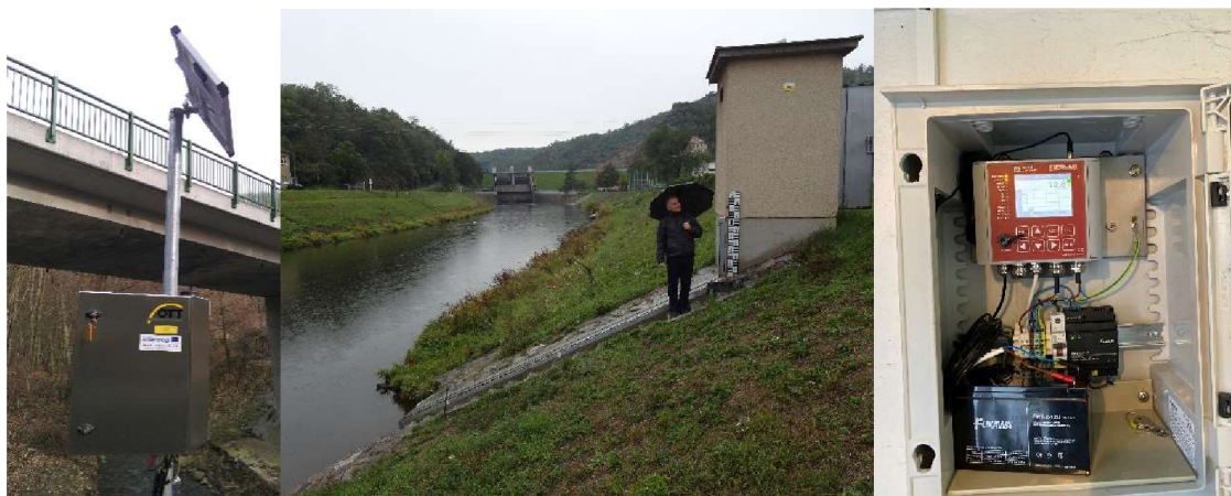
Obr. 10. Napájení elektřinou ze solárního panelu (vlevo), limnigrafická stanice (uprostřed), skříňka se zapisovačem dat a akumulátorem (vpravo) [3]
