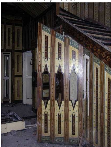
77. Dřevěné dekorované obložení ve schodišťové síni (výzdoba František Kysela), stav před demolicí, 2008.
