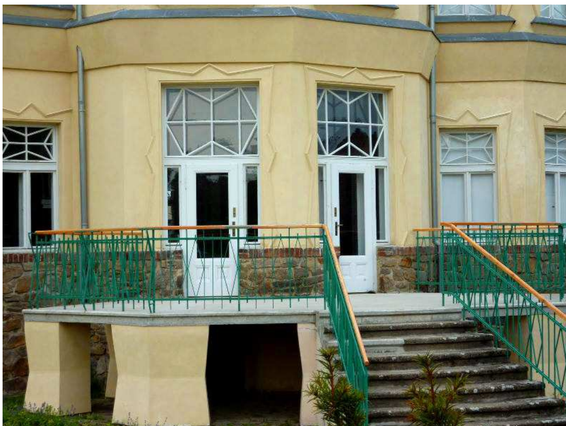
55. Kubistické orámování oken a dveří, kubistické mřížoví, zábradlí verandy a nosné pilíře, 2013.
