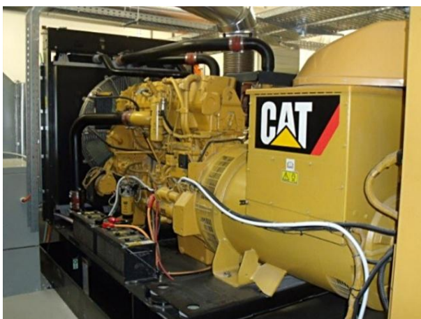
Obrázek 4: Záložní zdroj elektrické energie v budově IBC Ostrava
