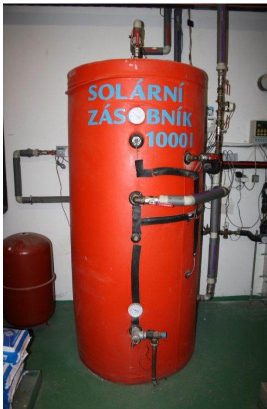
Obr. 3.4: Solární zásobník 1000 l [fotografie autor]
