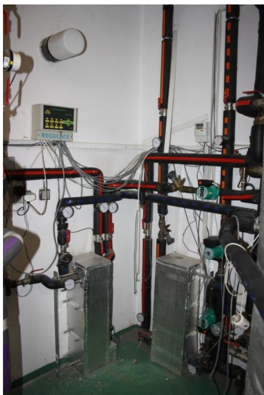
Obr. 3.5: Pohled na výměníky a další infrastrukturu [fotografie autor]
