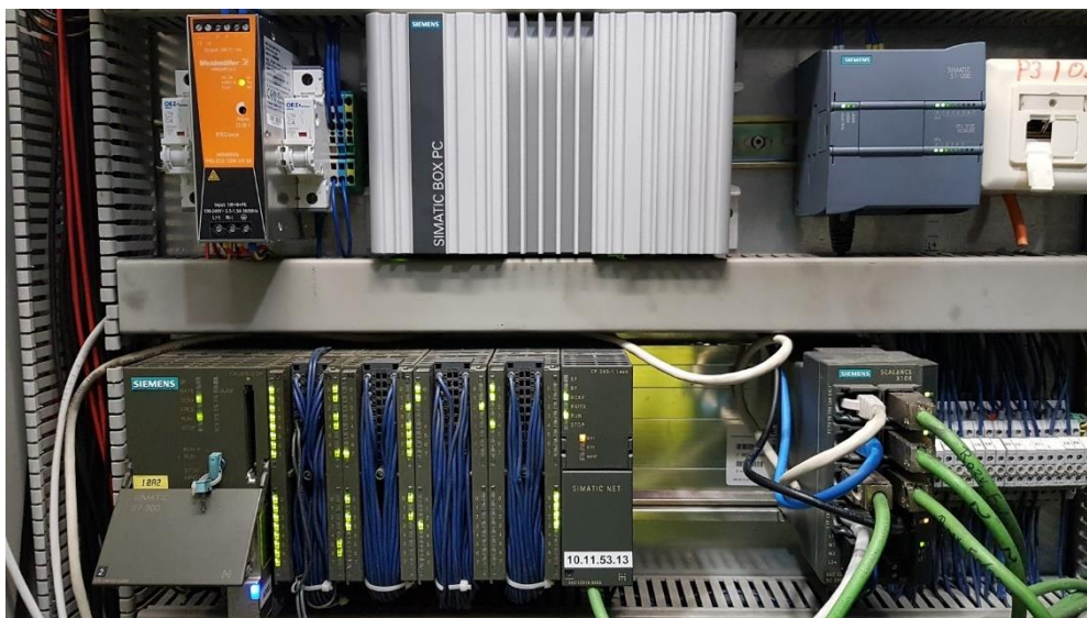
Obrázek 4.4-1 Instalace lokálního serveru pro testování
