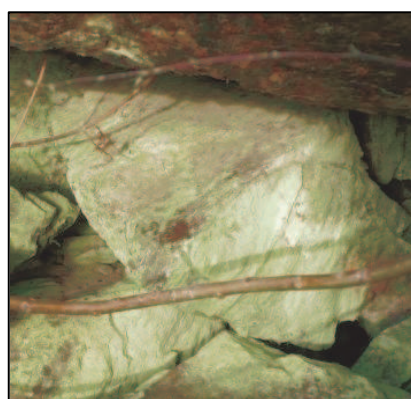
Obr. 28: Rozpadové stádium lišejníku na kameni
