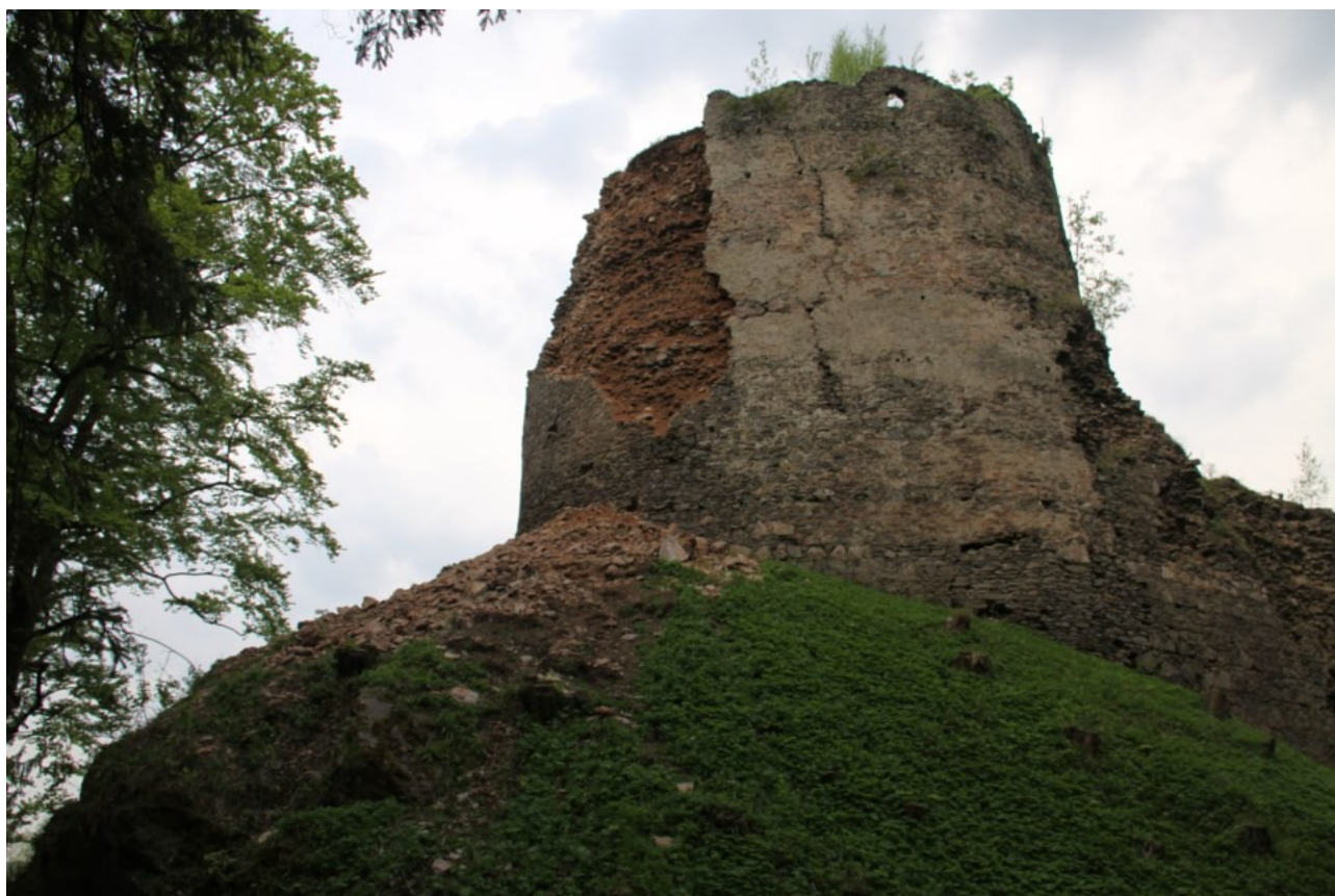
Obr. 13 Fotografie zobrazující poškození zdiva věže, ke kterému došlo 9. května 2013
