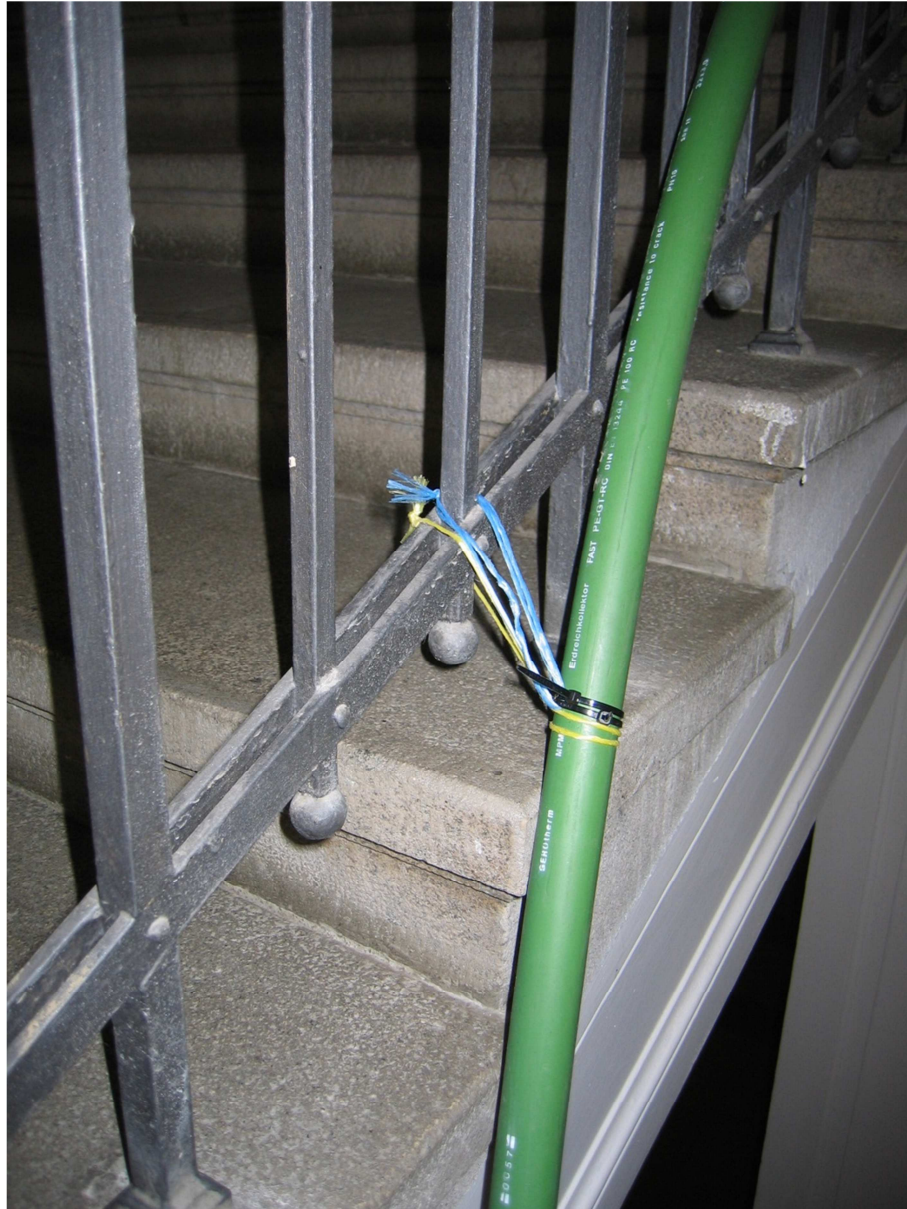
Obr. 53: Detail upevnění potrubí výměníku v prostoru schodiště budovy B FAST VUT.
