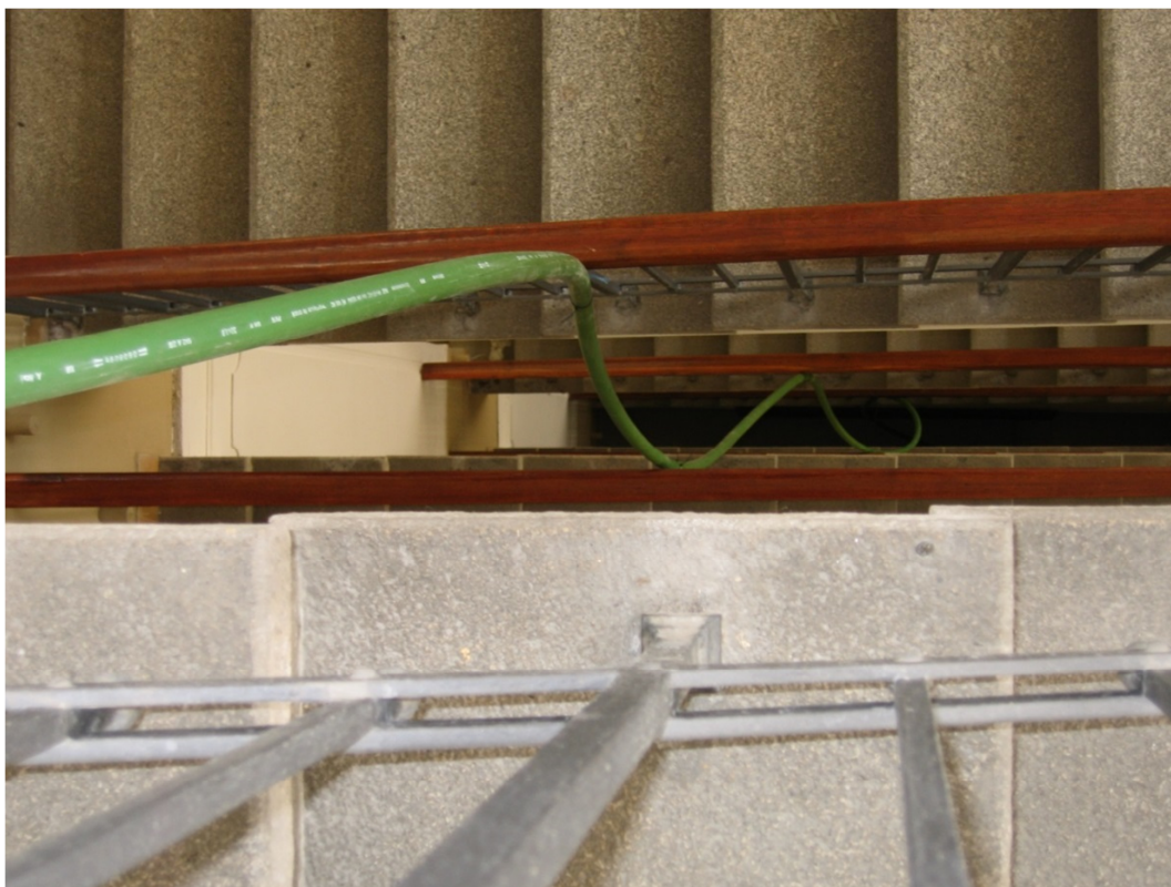
Obr. 52: Zkušební polygon – zavěšená trubka výměníku v prostoru schodiště budovy B FAST VUT.
