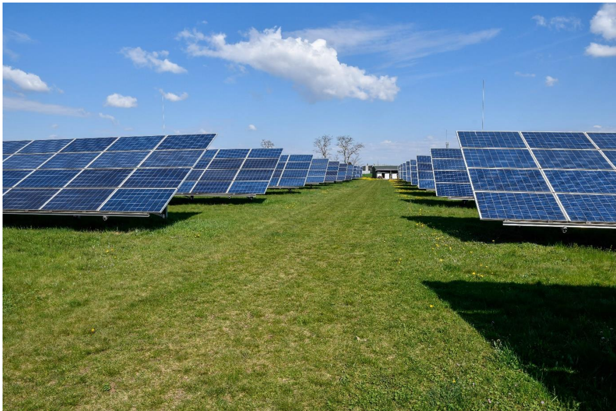
Obrázek 12: Fotovoltaická elektrárna Žabčice
