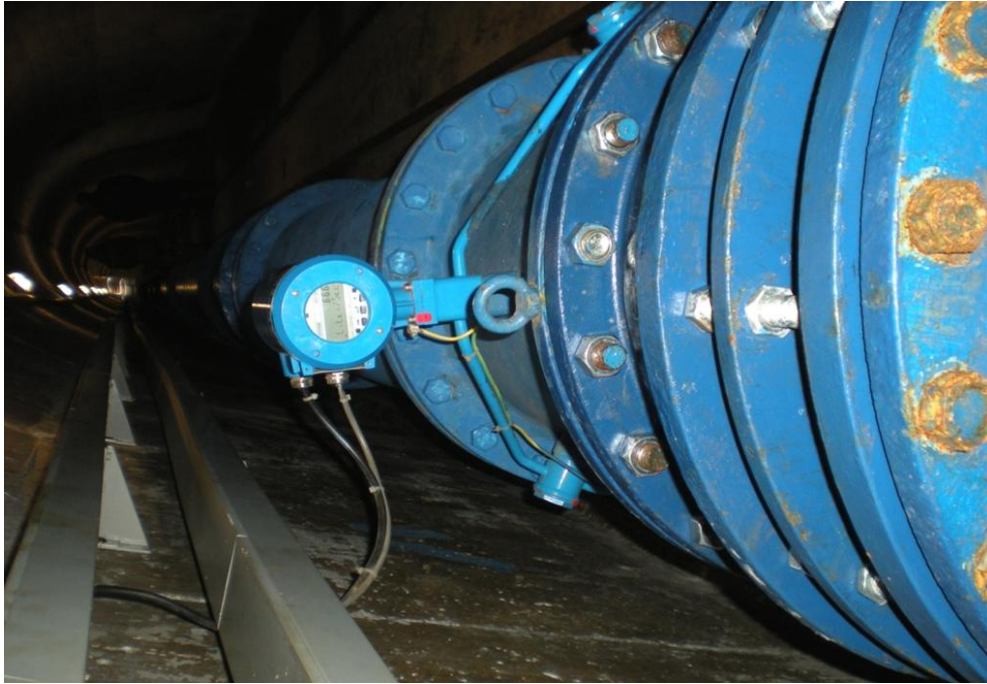
Obr. 11: Potrubí DN 500 na vodárenské účely v komunikační štolě, (Křížová, 2014)
