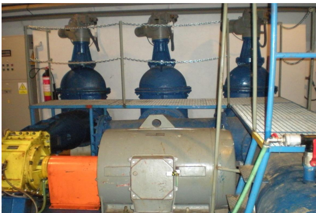
Obr. 12 : Malá vodní elektrárna, (Křížová, 2014)
