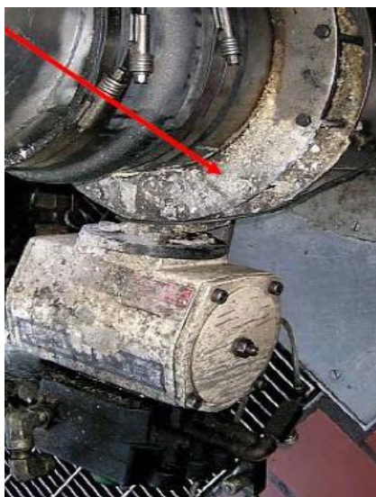
Obr. 4-19 Koroze způsobena AdBlue [57]
