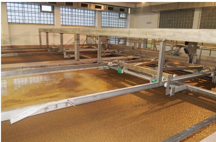
Obr. 8: Shrabovací mechanismus kalu flotační linky Úpravny vody Hradec Králové 8
