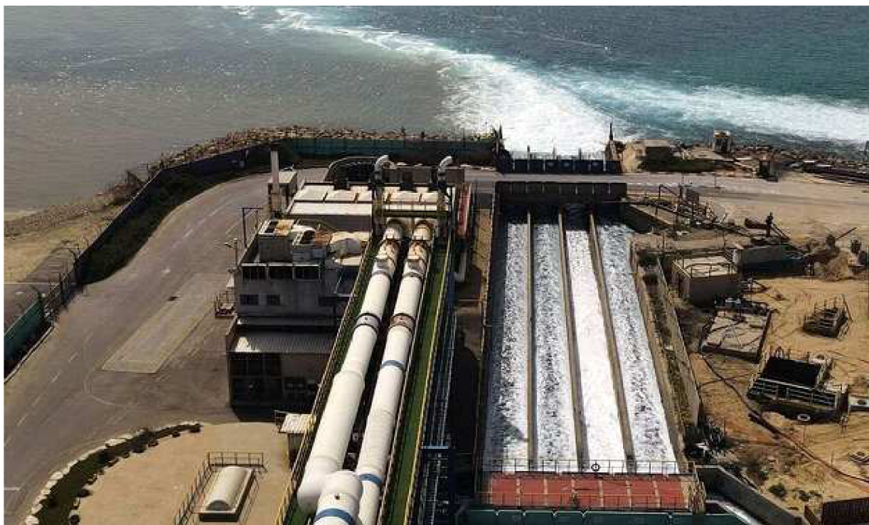
Obr. 2 Odsolovací zařízení vypouští odsolenou vodu do Galilejského jezera (převzato z https://www.al-monitor.com/ )
