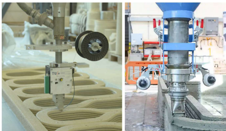
Obr. 3.22 Ukázka tisku s výztuží ve formě drátu/lanka (vlevo)[31], nanášecí hlava s kontrolními kamerami (vpravo)[15]
