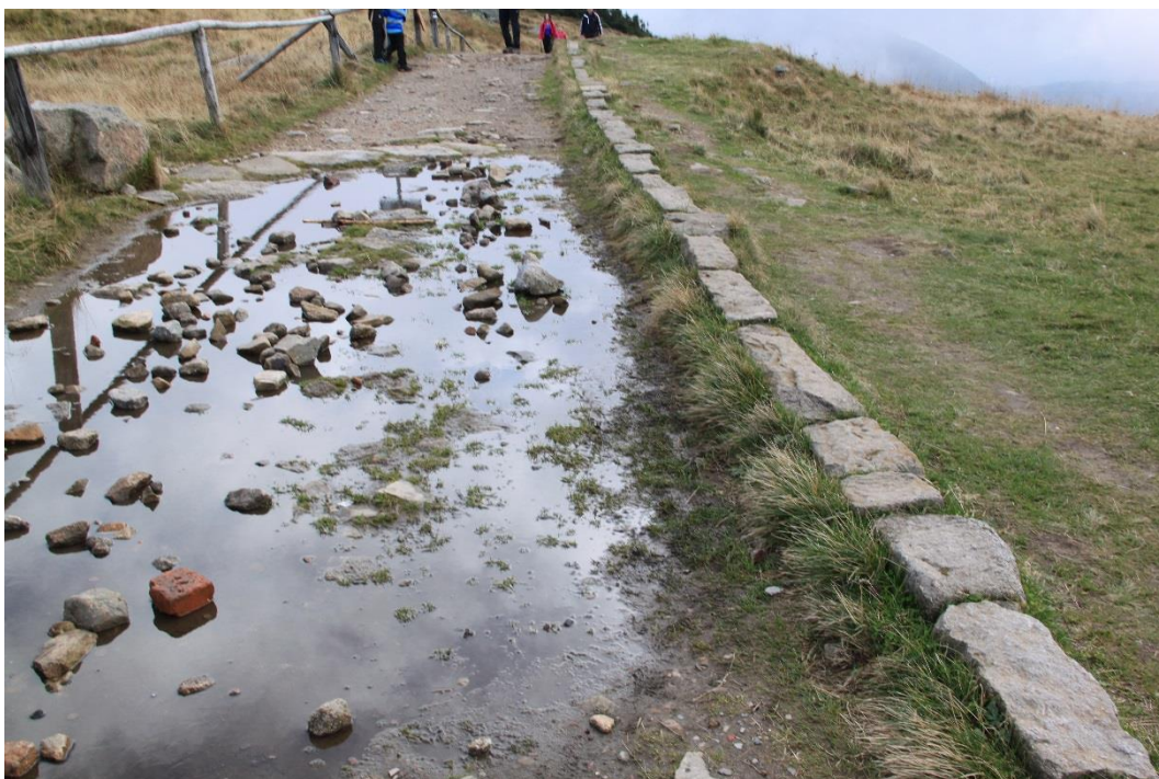
Obr. 3: Špatné odvodnění chodníku mezi Obřím sedlem a Obřím dolem. Foto autor
