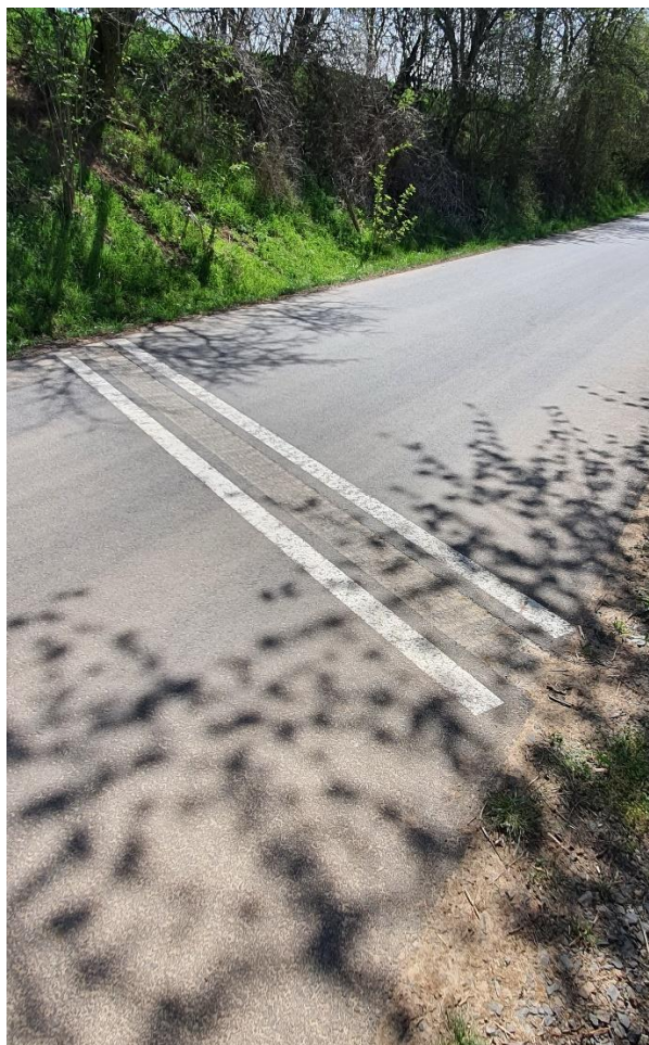
Příloha 11: Příčné odvodnění PC HC6 vyfrézováním vozovky ACO s reflexním označením, Vysoká u Mělníka 2020 (vlastní)
