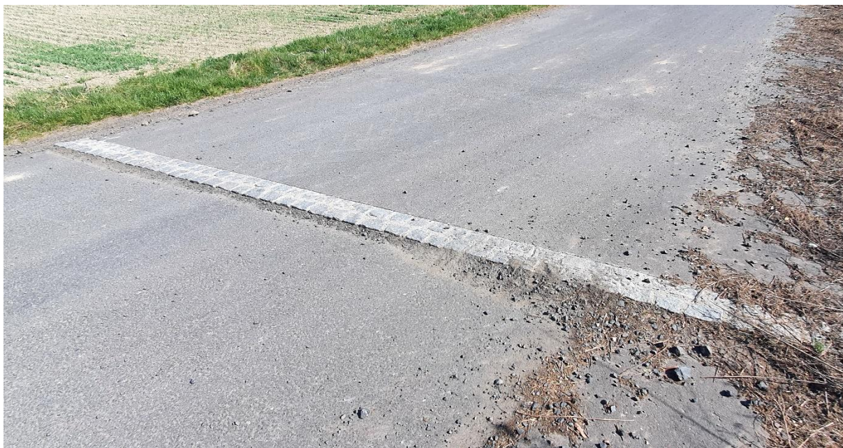
Příloha 10: Příčné odvodnění PC HC3 kamennou dlažbou do cementové malty, Ješovice 2020 (vlastní)
