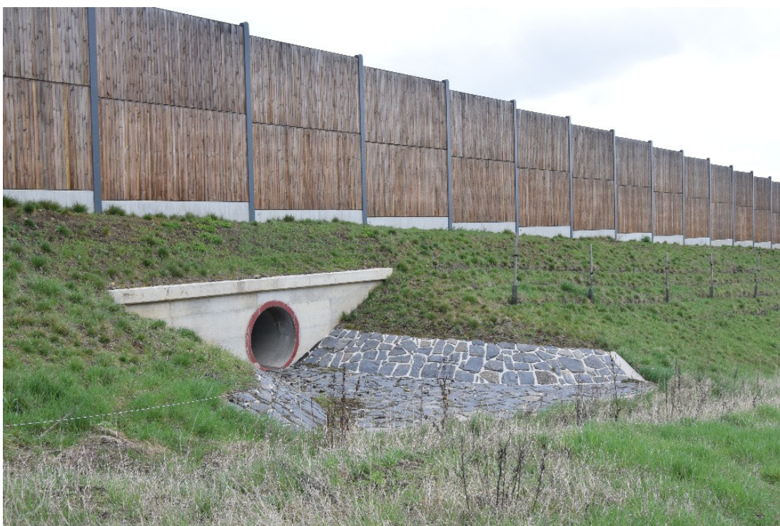
Obrázek č. 24 – Plocení dálnice D8, 50,935 km směr Praha, pohled na oplocení, propustek (Radek Rösner 2016)
