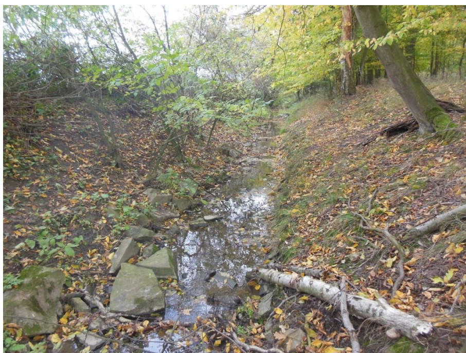
Obr. 14 Fotografie z úseku STA00010 – uměle zahloubené koryto s rozpadajícím se opevněním
