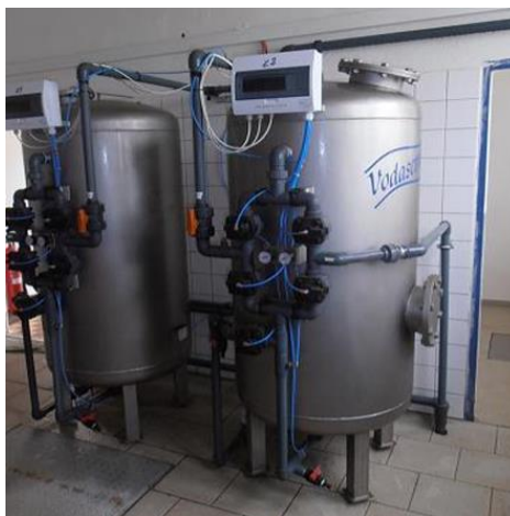
Obr. 6.1 Technologické řešení na odstranění pesticidů ze zdroje podzemní vody (800 obyvatel) [41]
