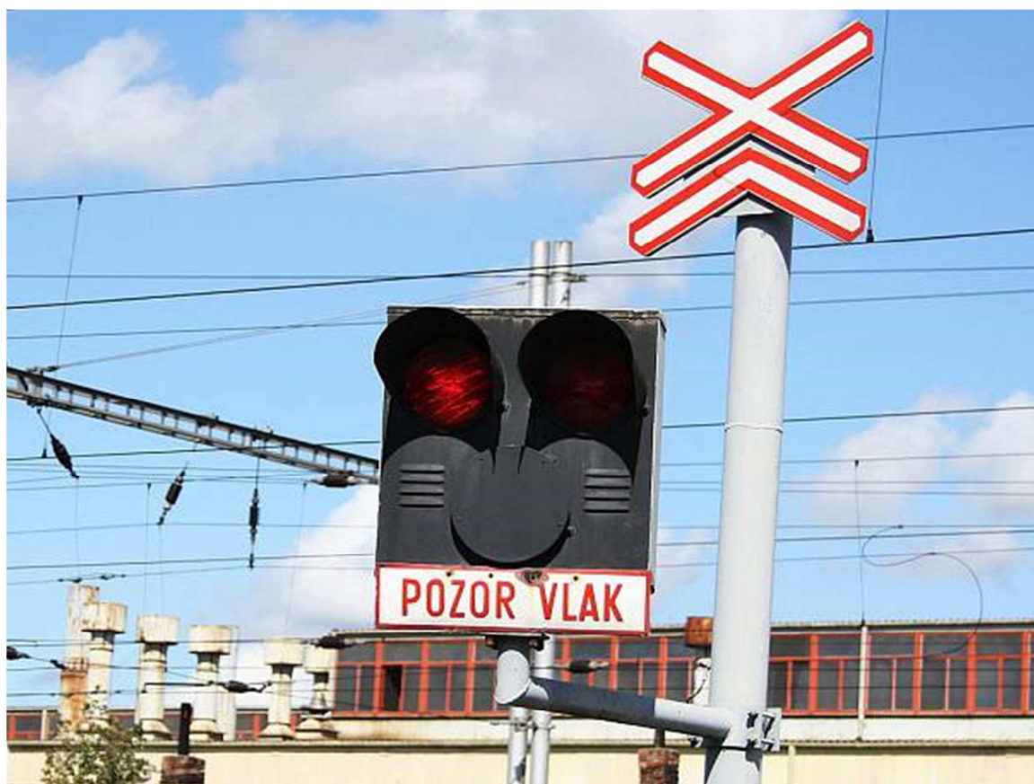
Obr. č. 4 – Přejezdové zabezpečovací zařízení světelné PZS [14]
