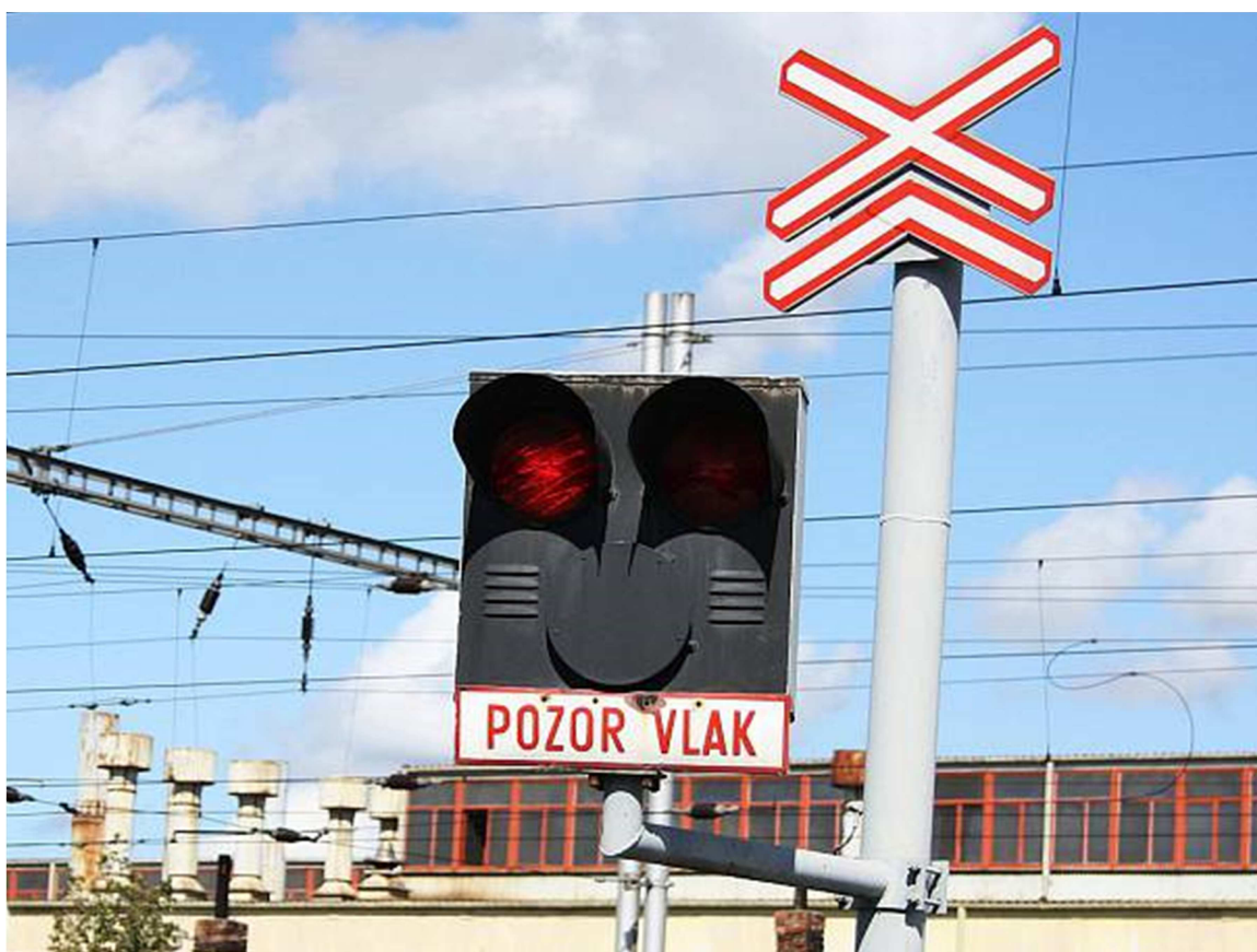
Obr. č. 4 – Přejezdové zabezpečovací zařízení světelné PZS [14]
