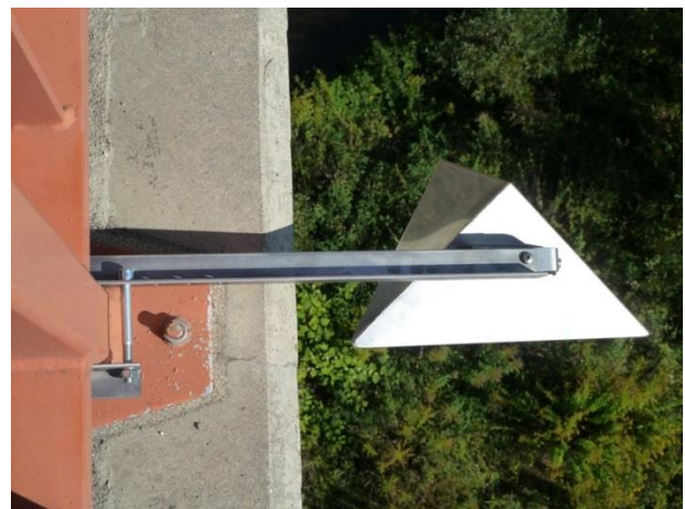
Obrázek 2.18 – Koutový odražeč osazený na zábradlí mostu [26]
