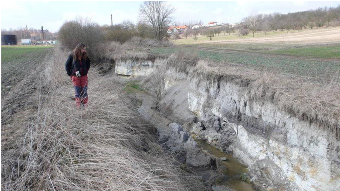
Obrázek 5 Pohled na propadlé koryto (před rokem 2010) Loděnického přítoku pod Novým Strašecím (AOPK, 2021)
