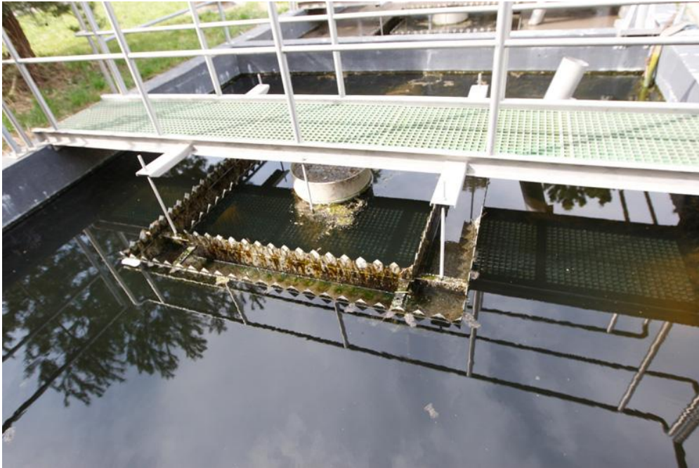
Obr. 8 ČOV Zeleneč - dosazovací nádrže, Skoková, 2011.
