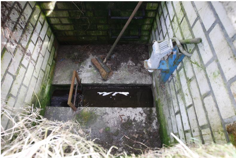
Obr. 9 ČOV Zeleneč - měrný objekt (vyčištěná voda je odváděna do recipientu), Skoková, 2011.
