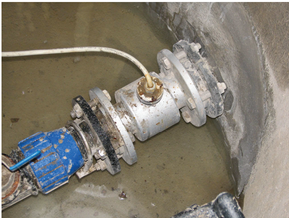
Obr. 3.9 Osazení indukčního průtokoměru v šachtě
