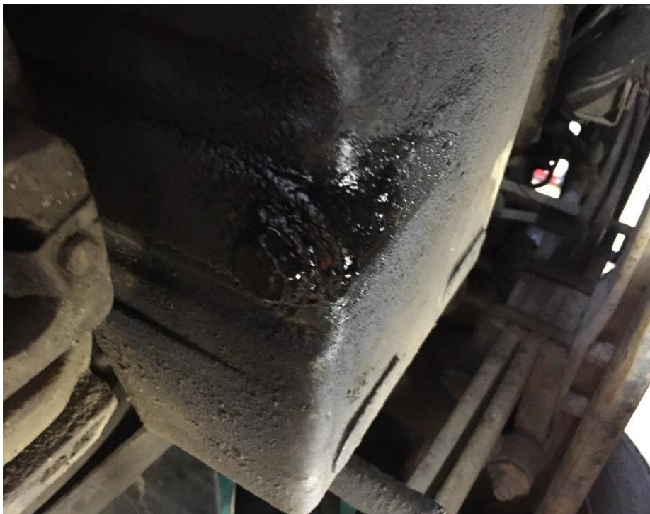
Obrázek č. 39 Únik oleje netěsností u vypouštěcího šroubu olejové vany AVIA (vlastní foto)
