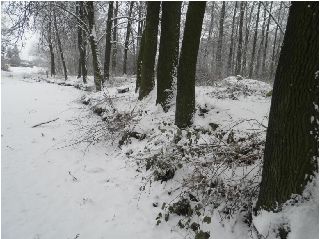
Foto č. 4 – Pohled J na narušený návodní svah
