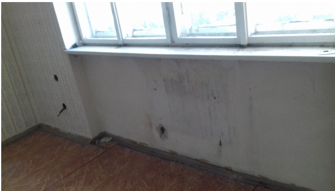
Obrázek č. 13 – Nevyhovující topení [vlastní zpracování]
