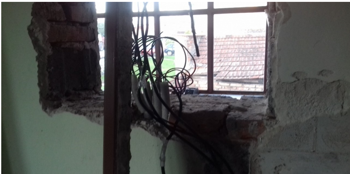
Obrázek č. 11 – Elektroinstalace v objektu [vlastní zpracování]
