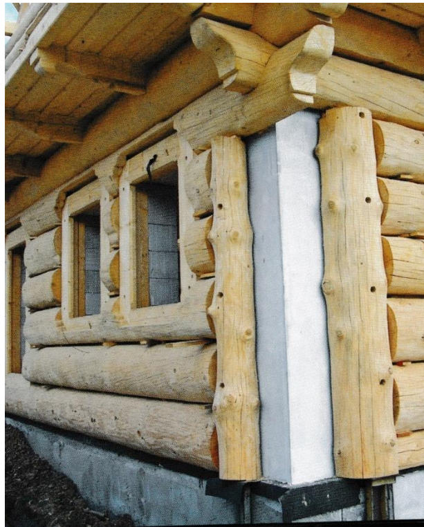
Obr. č. 14 Ukázka falešné srubové konstrukce
