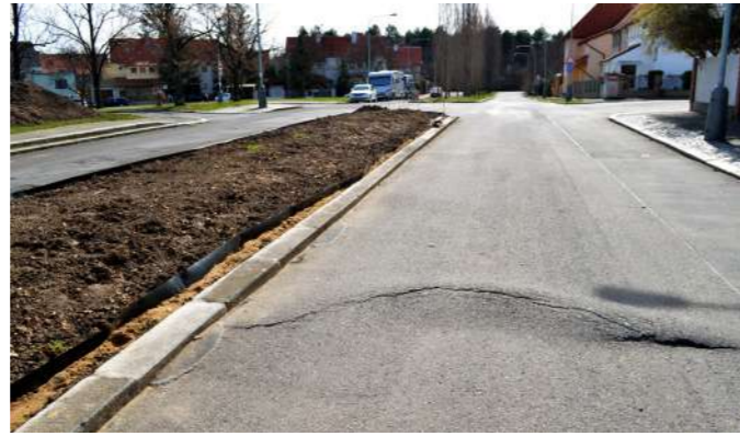
Obr. 59 Kořeny porušený asfaltový povrch
