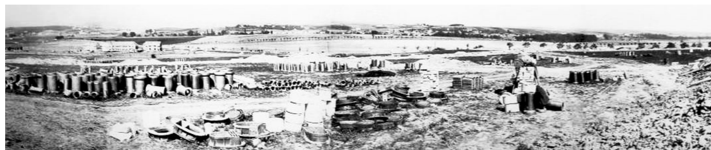
Obr. 34 Rozbitý materiál na staveništi Spořilova
