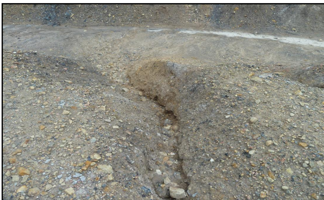
Obr. 23: Eroze příkopu (foto Jiří Ivanič, 2019)
