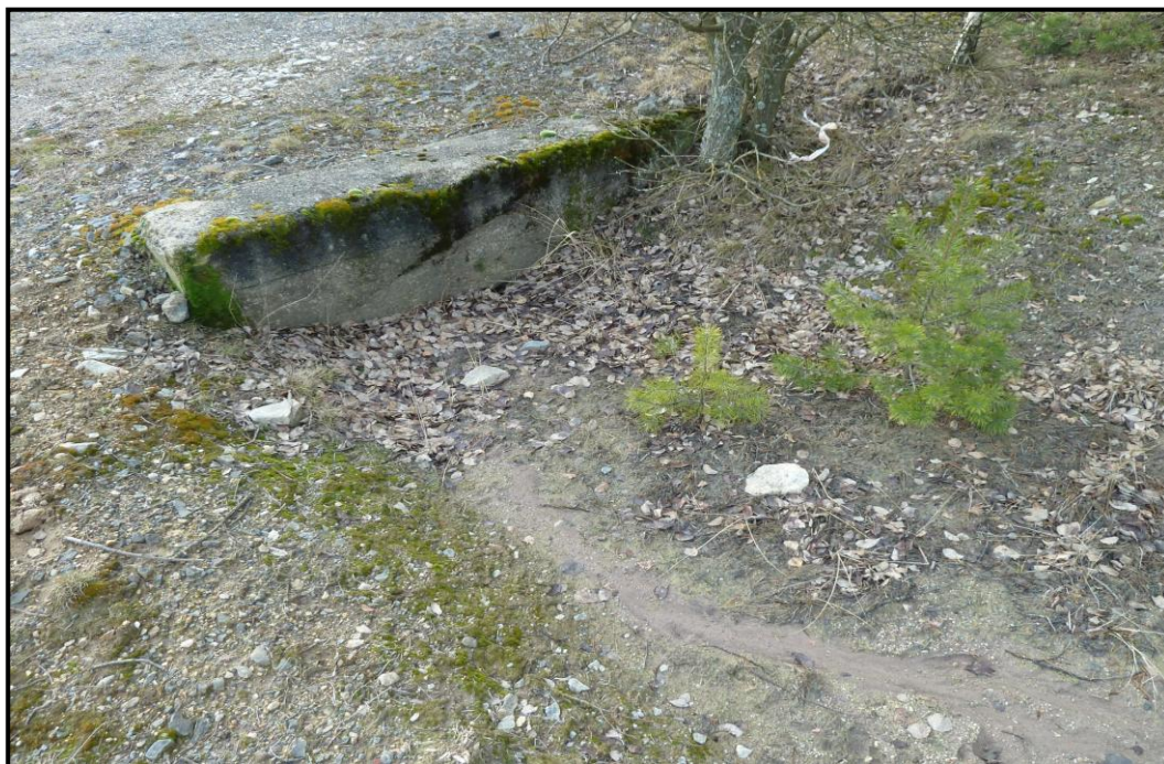
Obr. 22: Ucpaný propustek (foto Jiří Ivanič, 2019)
