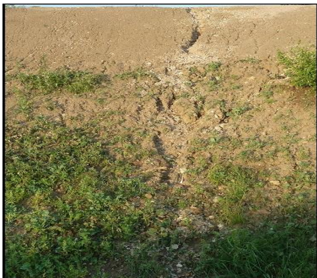
Obr. 1: Eroze svahu obchvatu města Sokolov (foto Jiří Ivanič, 2019)
