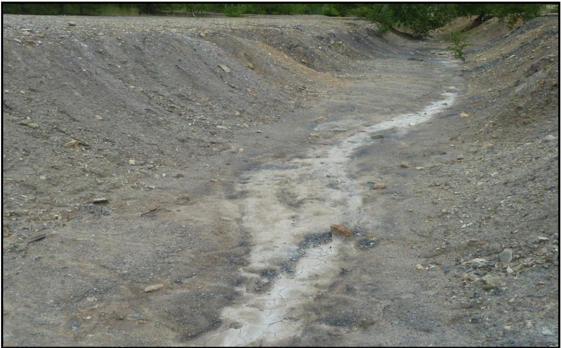
Příloha 1: Produkty eroze ve svodném příkopu (foto Jiří Ivanič, 2019)
