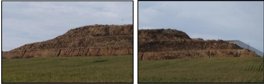
Obr. 3a, b: Eroze výsypky skryté ornice při stavbě výrobní haly v průmyslové zóně města Cheb (foto Jiří Ivanič, 2019)
