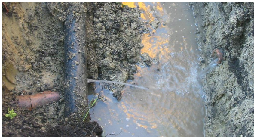
Obrázek 7: Porucha typu díra na vodovodním potrubí (aquadetecion.cz)
