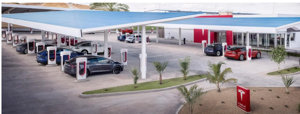
Obrázek 13: Tesla Superchargery se zdrojem elektřiny z fotovoltaických panelů
