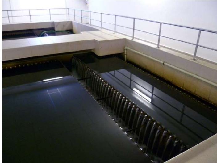
Obrázek 3 Tenkostěnné přelivy s trojúhelníkovým výřezem na úpravně vody [11]
