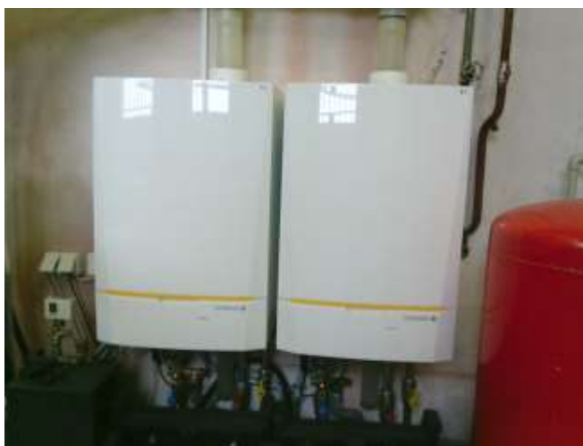
Obrázek 2.7 Kondenzační plynové kotle De Dietrich Innovens MCA 45
