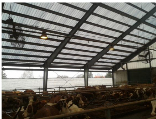
Obrázek 37 – Ventilátory SAH 36. Na Školním statku v Humpolci.
