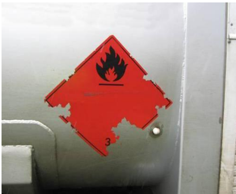
Obrázek 8.3 Poškozená bezpečnostní značka[61]
