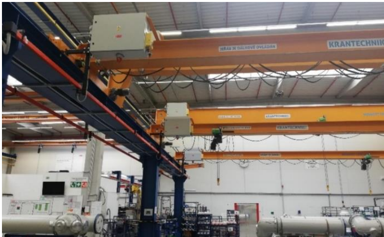
Obr. č. 2 - Mostové jeřáby [Vlastní]
