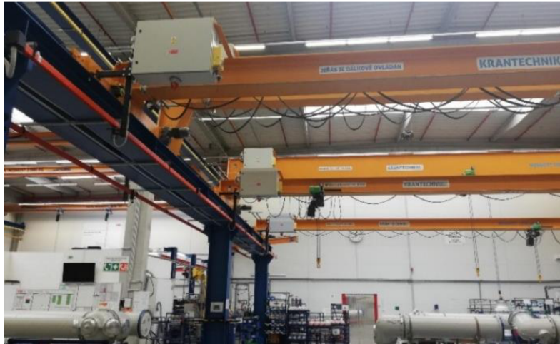
Obr. č. 2 - Mostové jeřáby [Vlastní]
