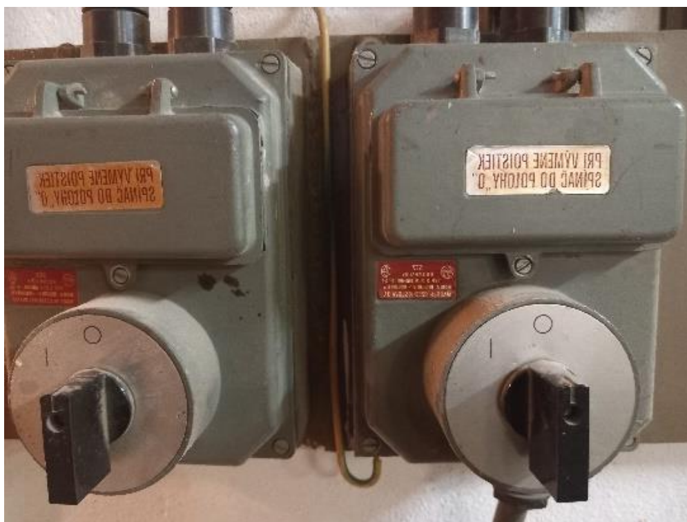
Obrázek 22 Hlavní elektro vypínač (foto autor)
