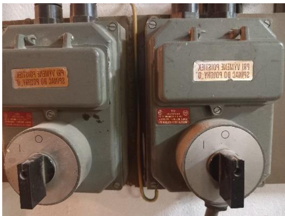
Obrázek 22 Hlavní elektro vypínač (foto autor)
