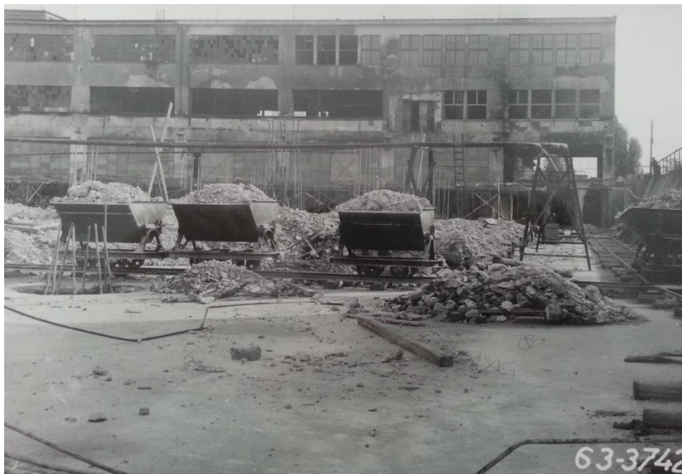
Odklizení sutě a trosek po náletu a požáru 9.5. 1945 (zdroj: Archiv společnosti Škoda Auto, fond ASAP č. 50 - Požáry, bombardování)
