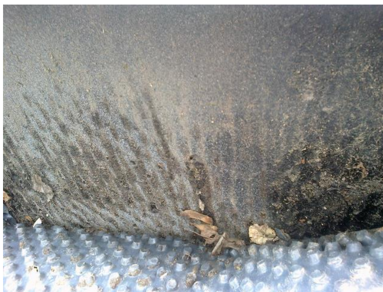
Obrázek 2-3: Poškození hydroizolace způsobené protlačení nopů vlivem hutnění
