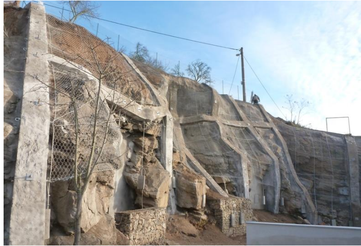
Obr.16 Tišnov, ul. Klášterská - sanace skalní stěny v zadním traktu obytného domu; ŽB žebra a aplikace SB se zavěšenými ocel. sítěmi v devonských vápencích (archiv autora)
