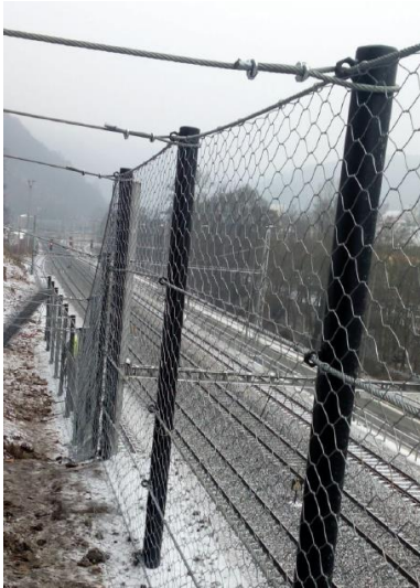
Obr.7 Trať č. 260 Brno – Č. Třebová km 171,330-171,650; těžký ochranný plot v. 2 m (archiv autora)
