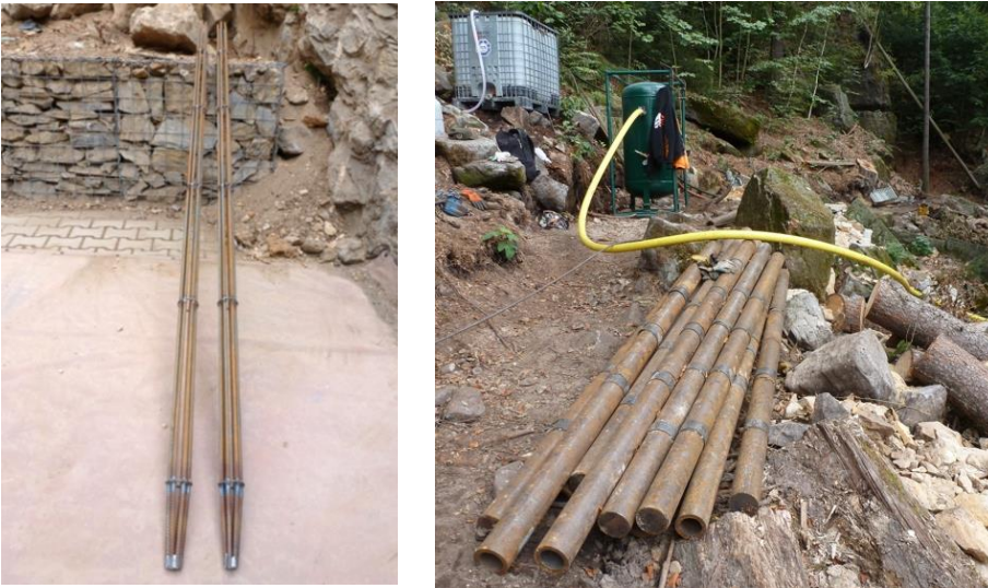
Obr.18 Dolní Žleb - výztuž mikropilot při založení patek dynamických bariér (vpravo); Tišnov - založení roznášecího prahu (vlevo) (archiv autora)
