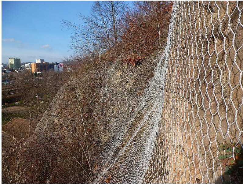
Obr.11 Brno-Královo Pole v ul. Myslínova; ocelová síť z r. 2006 ve formě závěsu s betonovým závažím, bývalý granodioritový lom (archiv autora)
