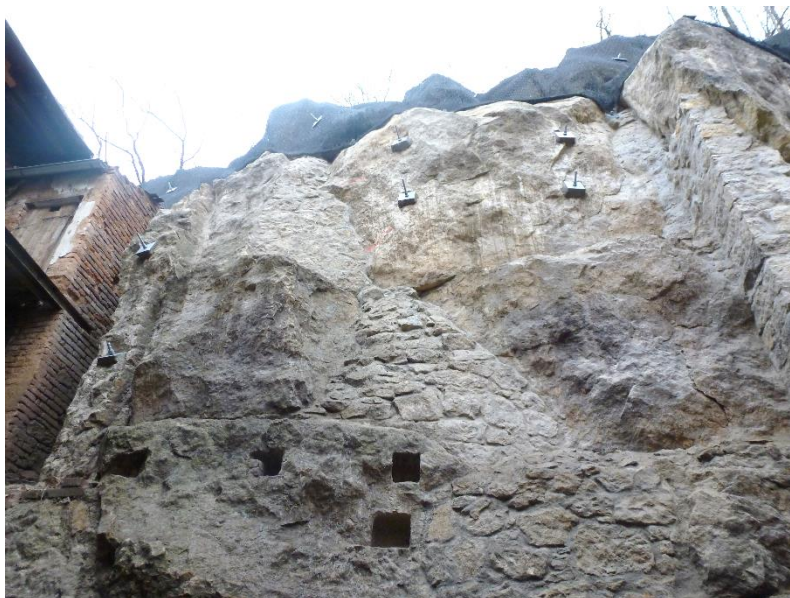
Obr.13 Krnsko - sanace skalní stěny v zadním traktu obytného domu, kombinace podezdívek, plomb a kotvení v kallianasových vápňitých pískovcích (archiv autora)
