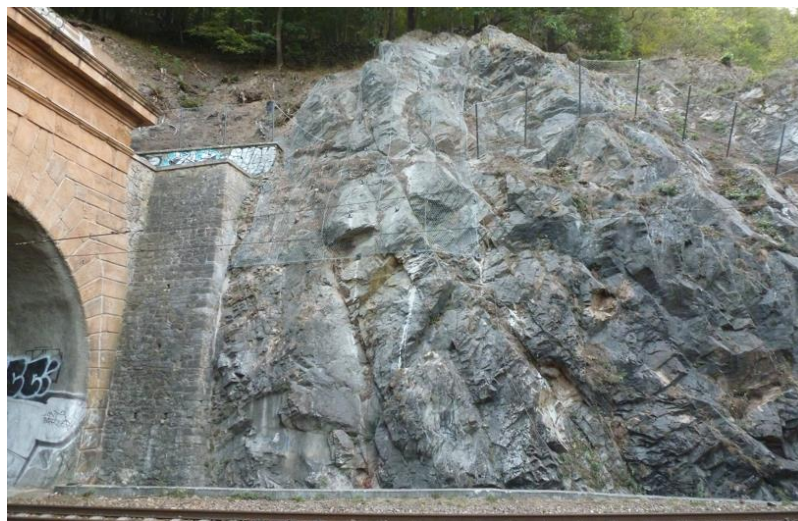
Obr.17 Tunel č. 8/1 - sanace skalní stěny u brněnského portálu, granodiorit typu Blansko (archiv autora)
