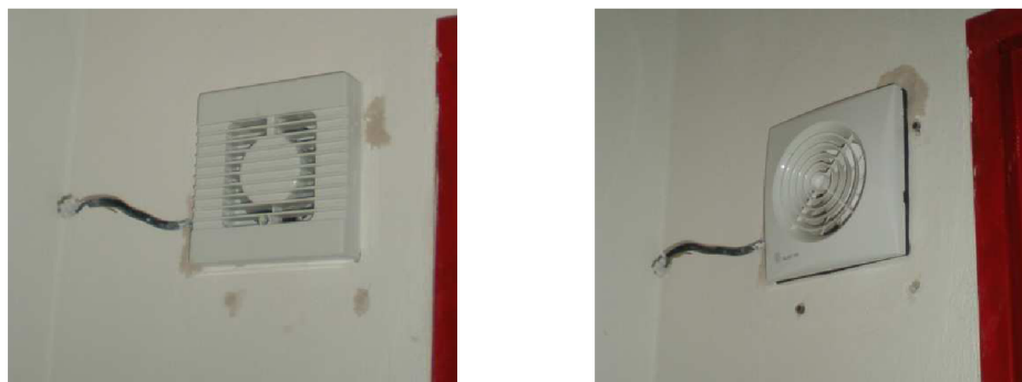
Obr. 4 Příklad osazení ventilátorů - vlevo var.1 bez pryže, vpravo var.3 s pryží
